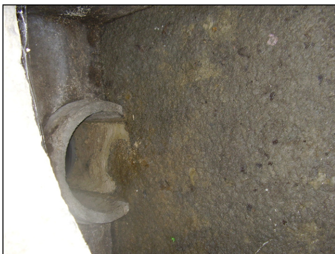
Photo 1 : Importants dépôts de graisse place du Général de Gaulle
