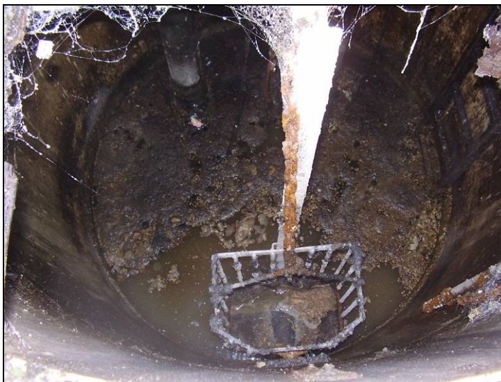
Photo 6 : PR Maupassant - Encrassement important et dégradation par l'H2s
