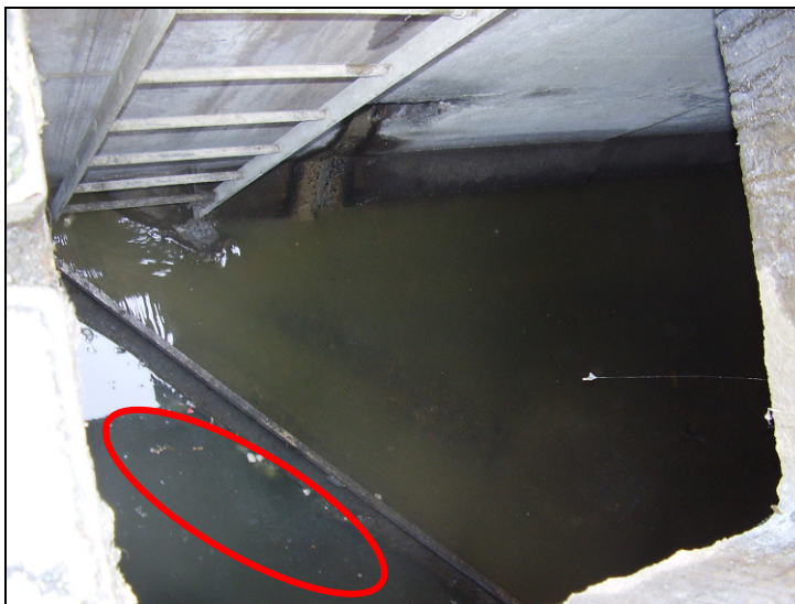
Photo 9 : DO 1 Mairie –Traces de déversements
