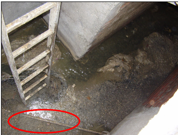
Photo 12 : DO 4 Casino – Présence de dépôts importants et traces de déversements
