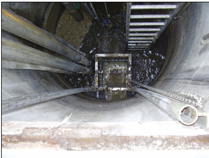
Photo 2 : Bâche du PR Mairie
