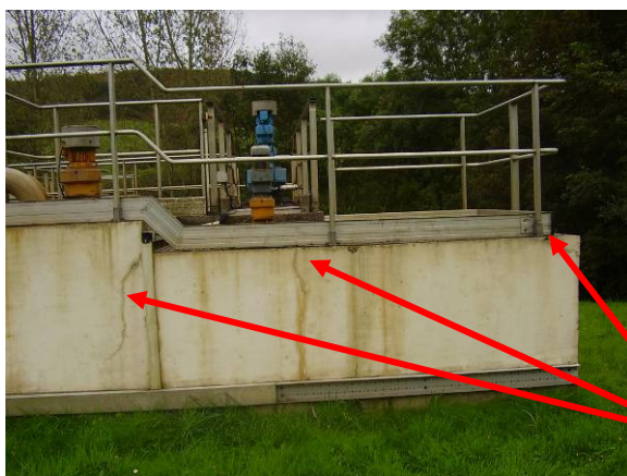
Photo 15 : Fissures multiples sur le décauteur lamellaire
