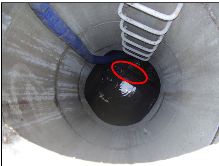
Photo 13 : DO5 rue Abbé Cochet – déversement
