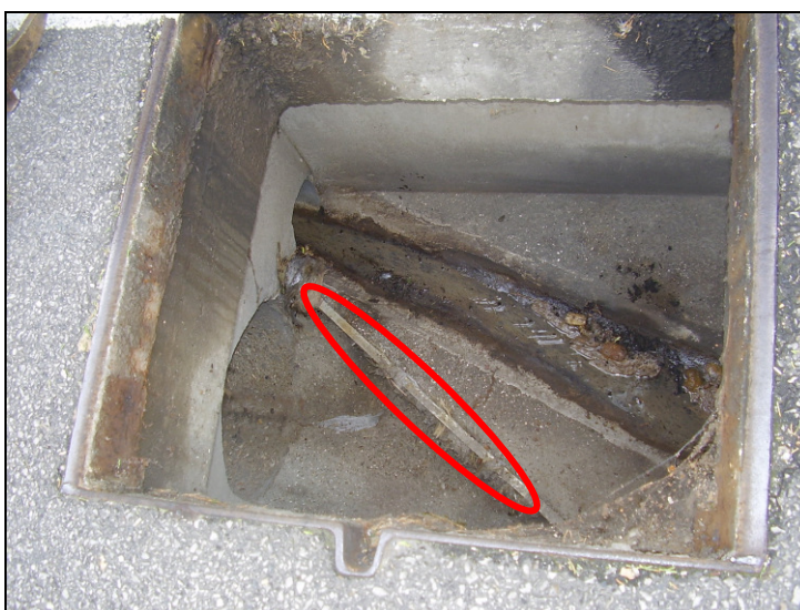
Photo 11 : DO3 rue Jules Gerbeau –traces de déversement au niveau de la lame
