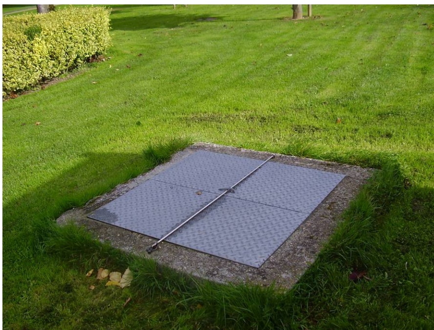
Photo 8 : Trappe d'accès du PR non accessible lors de notre visite
