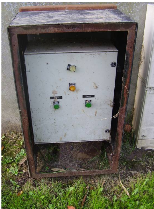
Photo 7 : PR Maupassant – Armoire électrique du PR
